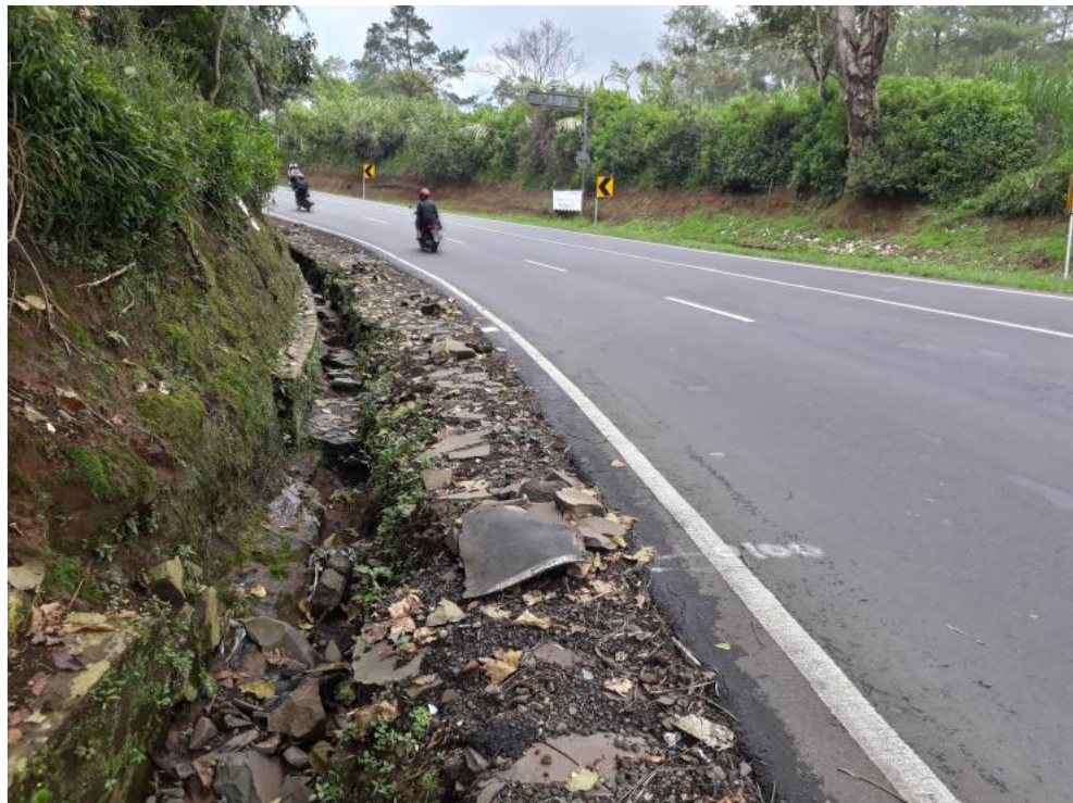
Gambar 20. Kondisi drainase Jalan Turunan Emen.
