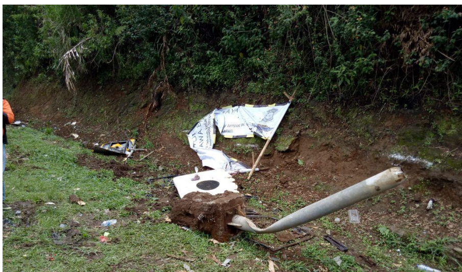
Gambar 6. Kerusakan rambu chevron .
