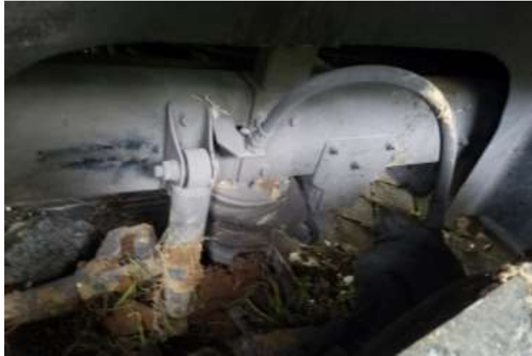
Gambar 6. Selang Fleksibel Rem Roda Kiri Kondisi Tidak Retak/Pecah
