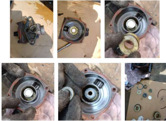
Gambar 17. Kondisi relay valve
