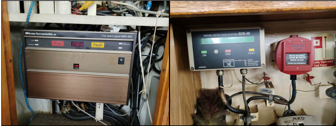
Gambar I-26: Panel alarm kebakaran (kiri); Panel deteksi asap (kanan)
