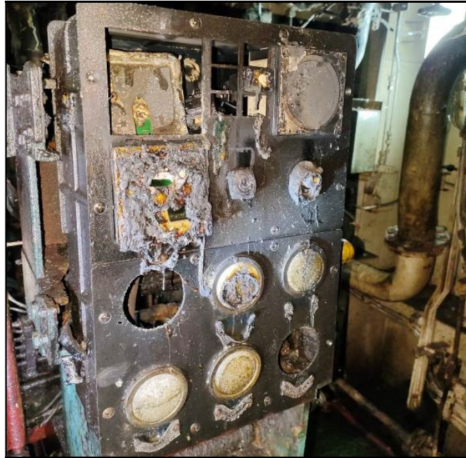
Gambar I-8: Kondisi Terminal Kontrol Mesin Utama
