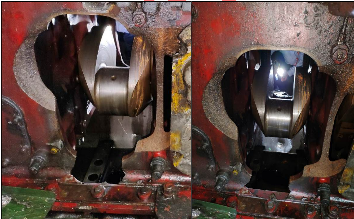
Gambar I-19: Kerusakan blok mesin sekitar pintu crankcase nomor 8 (tampak sebelah kiri)
