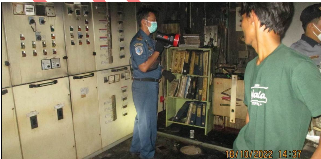
Gambar I-13: Kondisi ruang MDB
