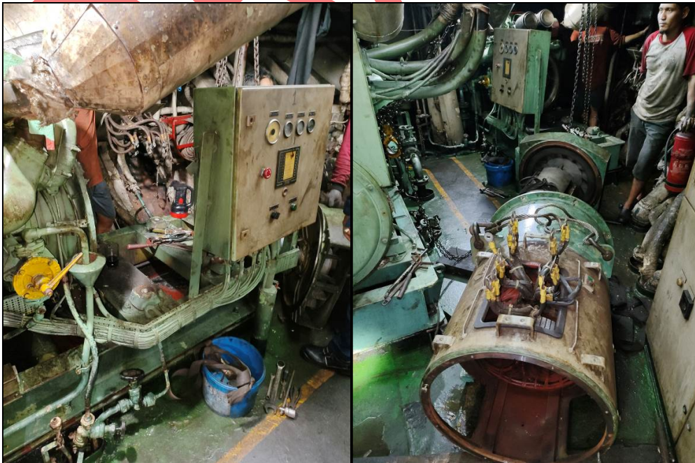
Gambar I-11: Generator nomor 1 sedang dibersihkan dan diperiksa
