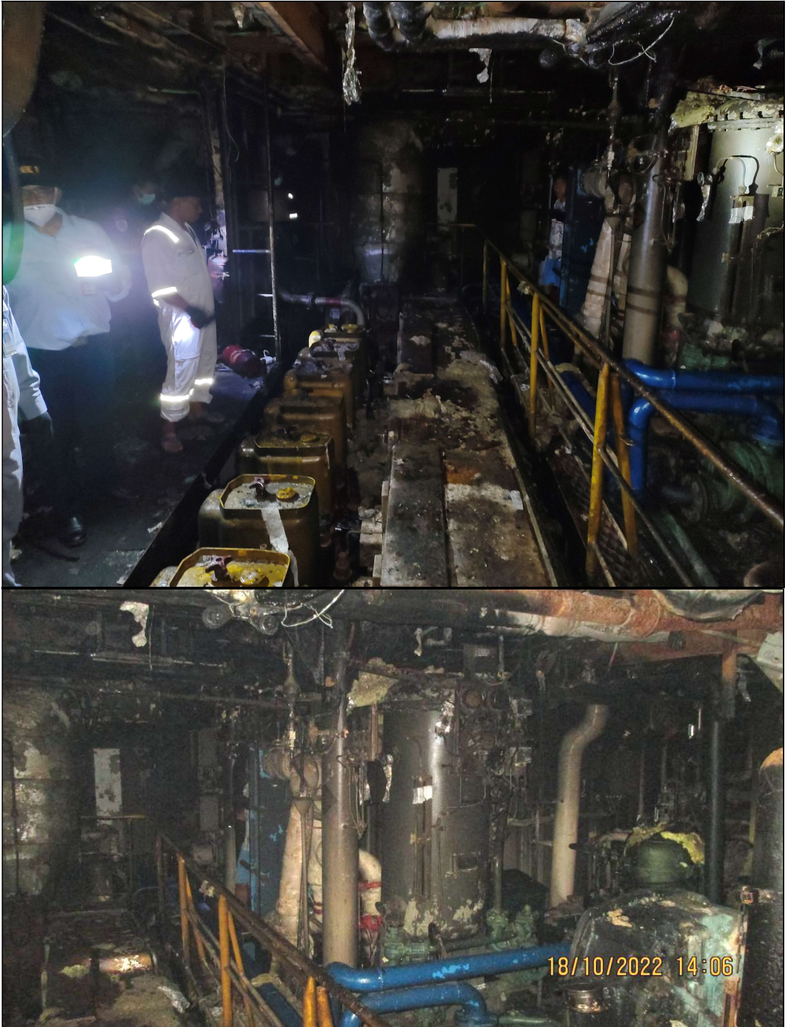
Gambar I-5: Keadaan dek-1 di kamar mesin pasca kebakaran
