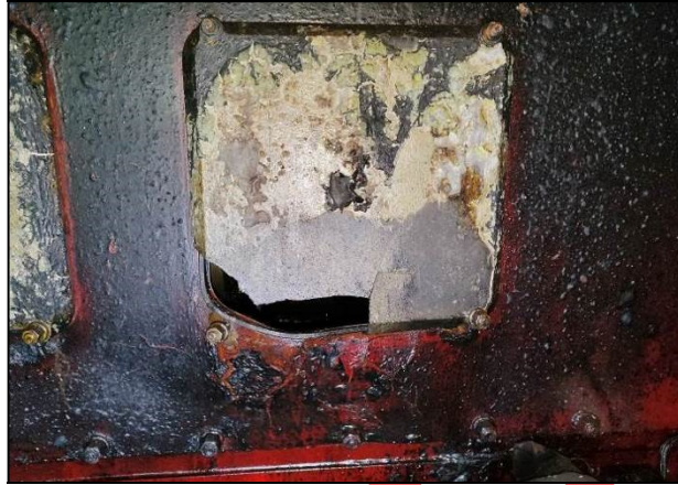
Gambar I-21: Penutup lubang camshaft di atas pintu crankcase silinder nomor 8 rusak
