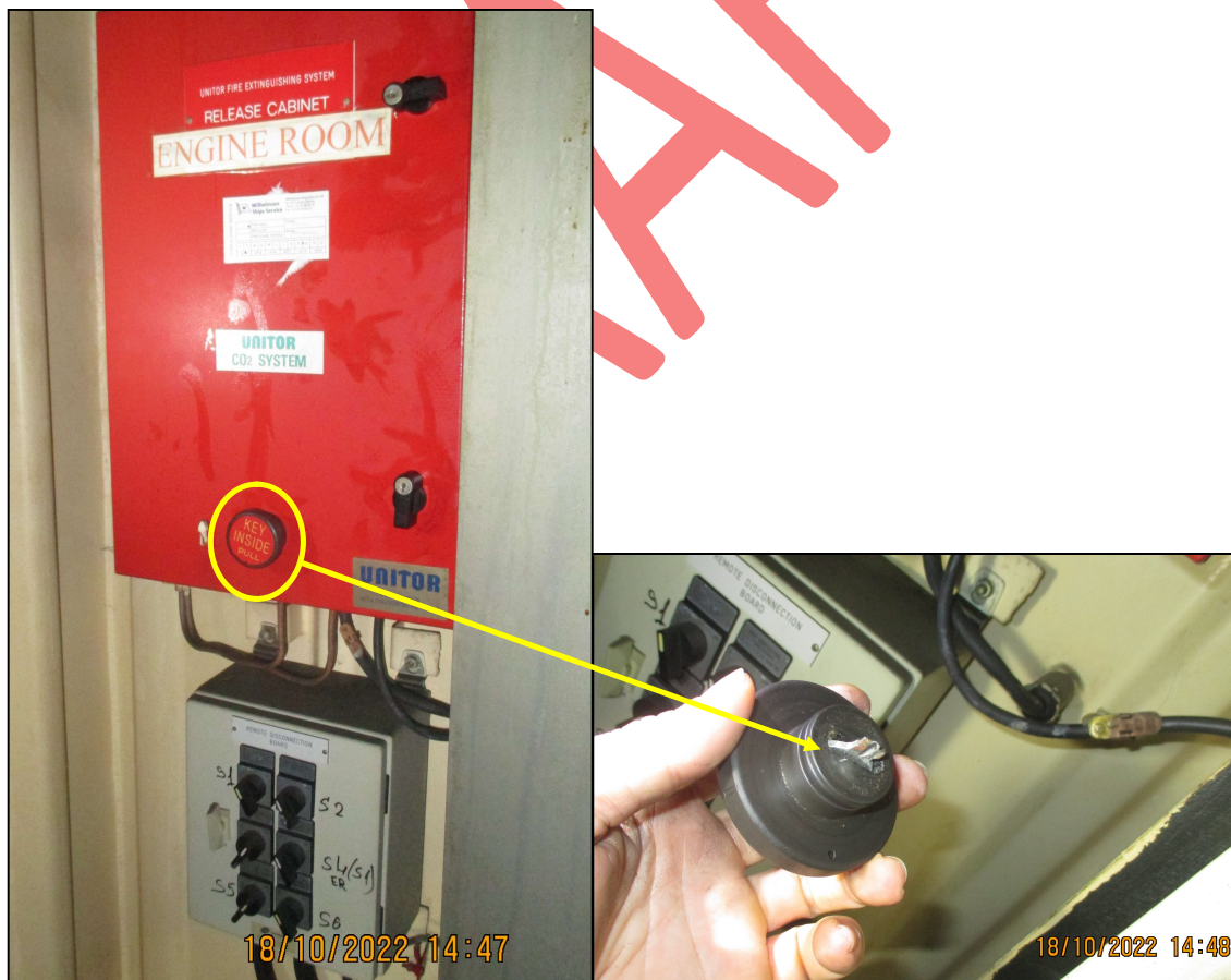
Gambar I-30: Remote release cabinet sistem CO2 ke kamar mesin, kunci kabinetnya patah
