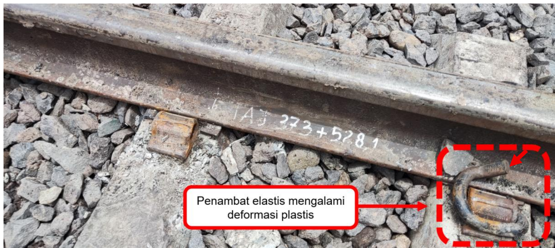
Gambar 20. Penambat elastis mengalami deformasi plastis
