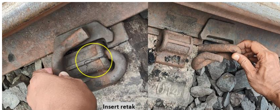
Gambar 12. Kondisi shoulder retak dan penambat mudah terlepas
