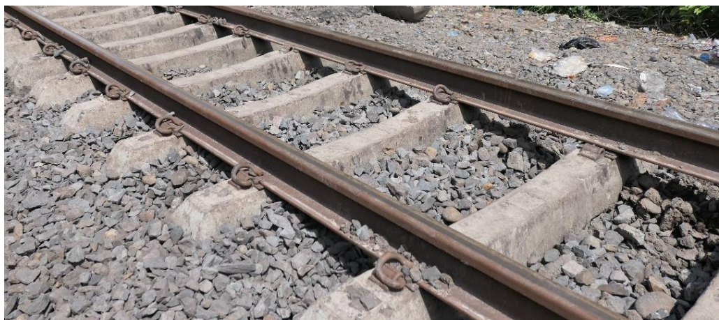
Gambar 10. Kondisi balas kurang
