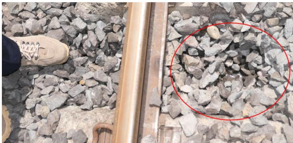
Gambar 11. Genangan air pada balas
