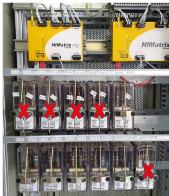
Gambar 18. Posisi relay interface pada BCR yang tidak memenuhi parameter pengukuran
