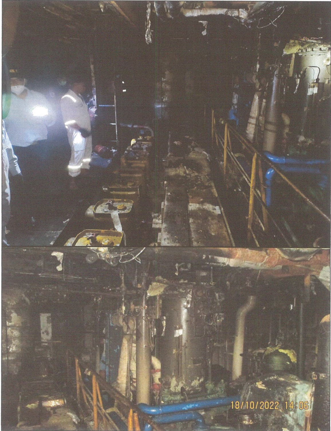
Gambar I-5: Keadaan dek-1 di kamar mesin pasca kebakaran
