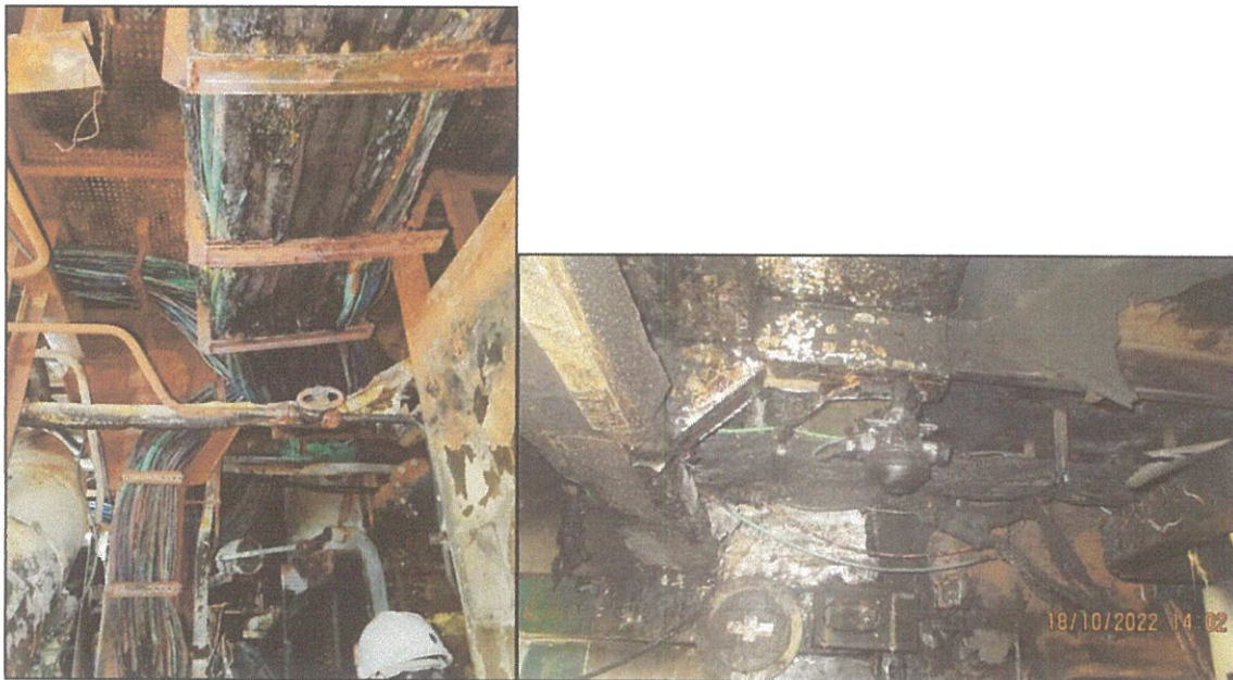
Gambar I-7: Kondisi perkabelan dan langit-langit di dek-1
