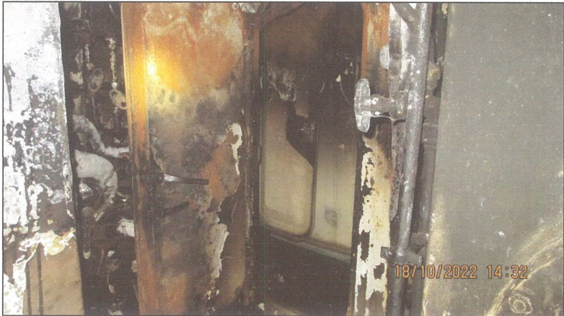
Gambar I-12: Kondisi pintu sebagai akses ke ruang MDB
