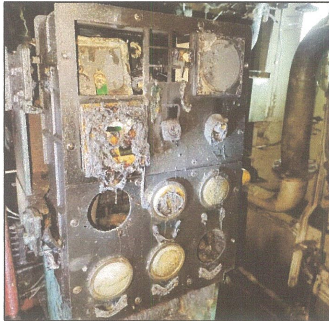
Gambar 1-8: Kondisi Terminal Kontrol Mesin Utama
