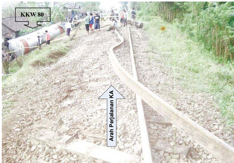
Gambar 2. Prasarana jalan rel R.42 yang putus/ bengkok dan KKW 80 yang anjlok dan terguling
