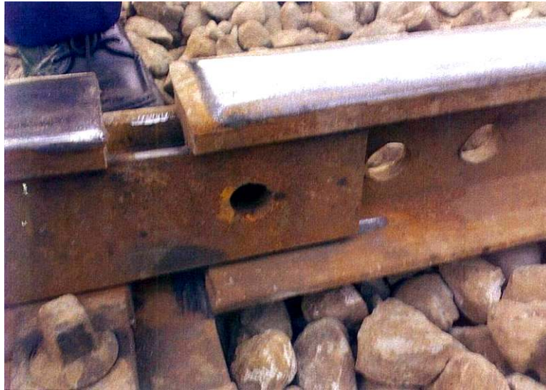
Gambar 6. Sambungan rel yang tidak standar tanpa baut pengikat plat sambung di Km 39+993
