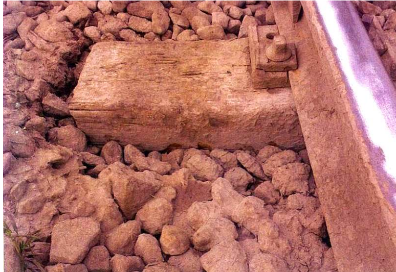
Gambar 8. Lapisan balas yang kotor akibat kecrotan di Km 39+993
