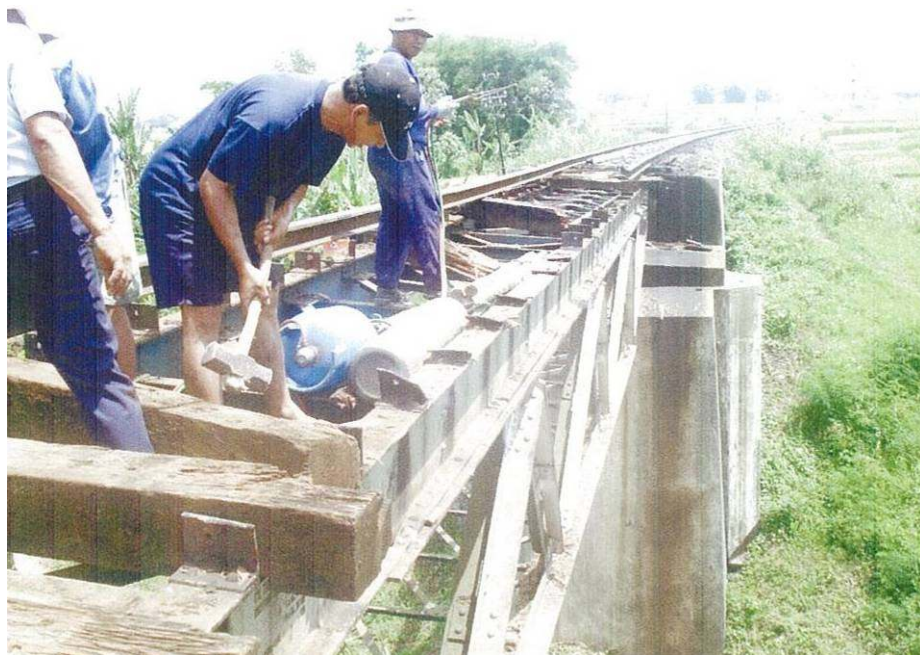
Gambar 3. Bantalan BH 187 yang rusak
